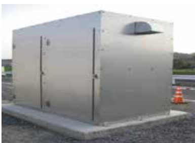
取水施設操作盤ボックス
