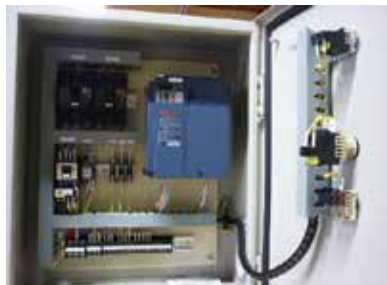
インバータ制御盤
