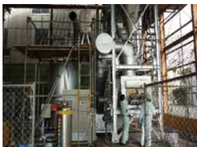
廃プラ分解油化装置
