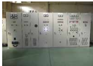
配電盤・制御盤
