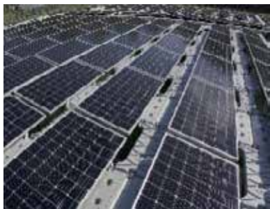
全国初のフロートを活用した 廃校プールでの太陽光発電システム！ 冷却効果で発電効率アップとなり、 廃校プール有効活用にもつながります。
