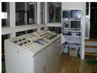
製糖用ミル遠隔制御盤
