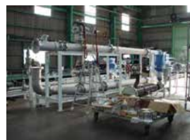
ユニット配管
