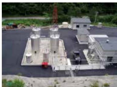
廃油再生設備
