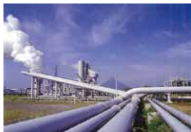
九州電力(株)山川発電所殿向
