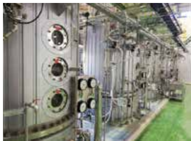
5缶4重効用式濃縮設備
