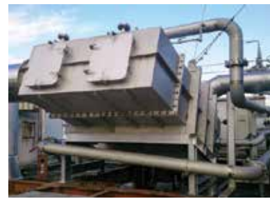
廃ガス冷却設備
