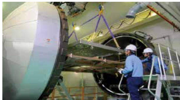
大型加圧蒸気封孔処理缶
