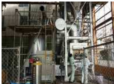
廃プラ分解油化装置
