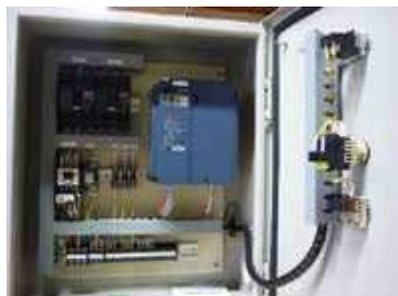
インバータ制御盤
