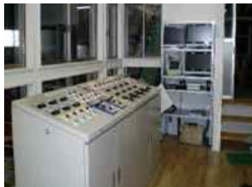
製糖用ミル遠隔制御盤
