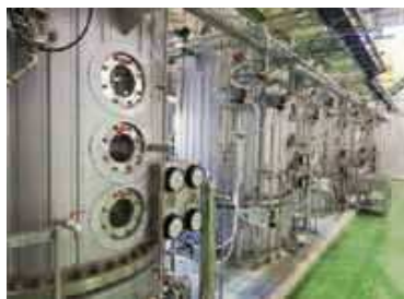
5 缶 4 重効用式濃縮設備
